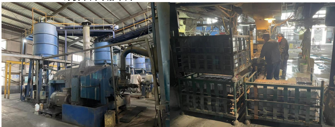
合膏区涂板车间
