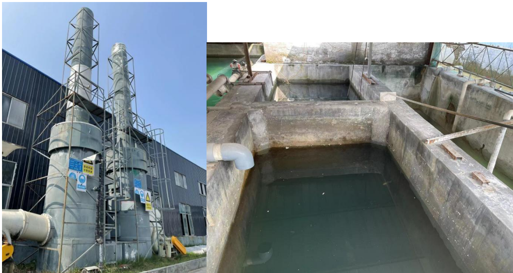
废气处理污水处理站
