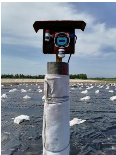
图 8-1-1 电子监控器及导气石笼排气管现场照片
